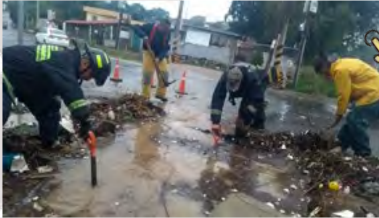
Imagen: Atención de emergencia derivado de las lluvias registradas
